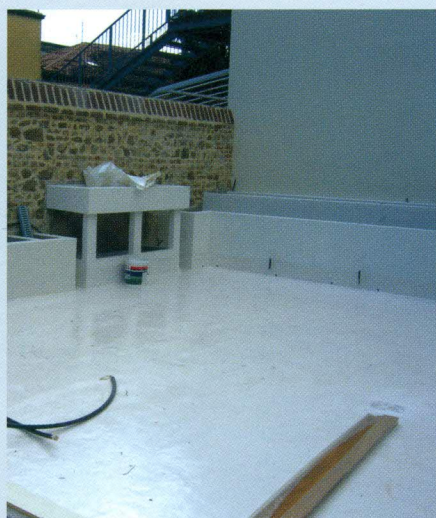
Si notino la totale assenza di giunti e sormonti e la perfetta adesione al sottofondo
